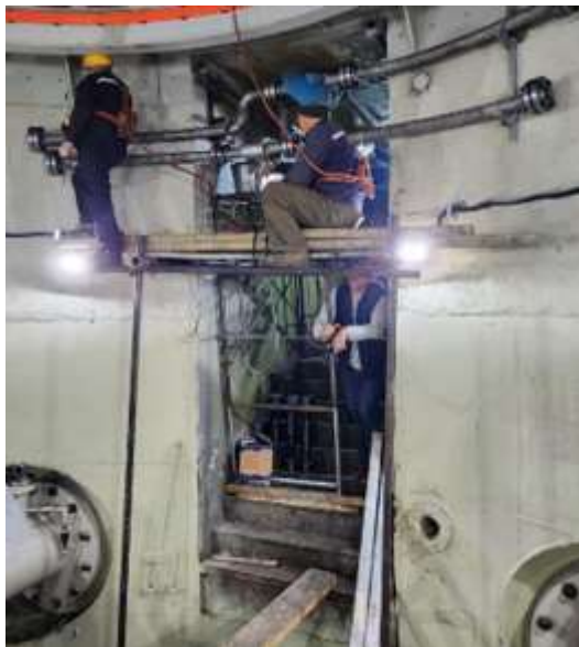
Рисунок 3: Леса находятся в крайне небезопасном состоянии.
